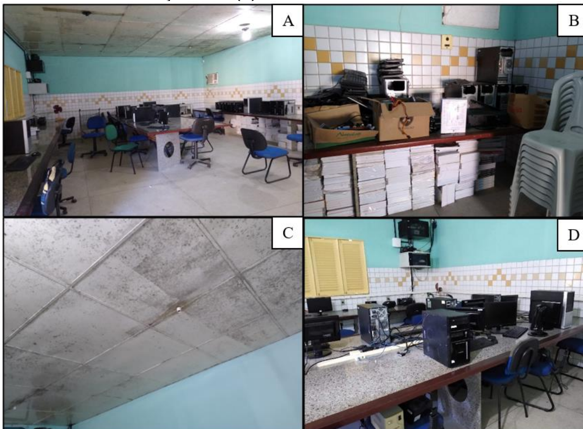
Figura 2 – Vista geral da sala de informática antes da reestruturação (A). Destaque para os materiais depositados na sala (B). Revestimento do teto com infiltrações (C). Materiais eletrônicos danificados e sem manutenção técnica (D).
