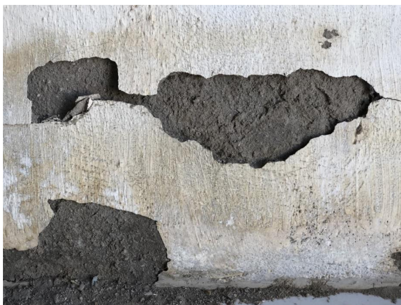
Figura 19 - Deslocamento área interna.
