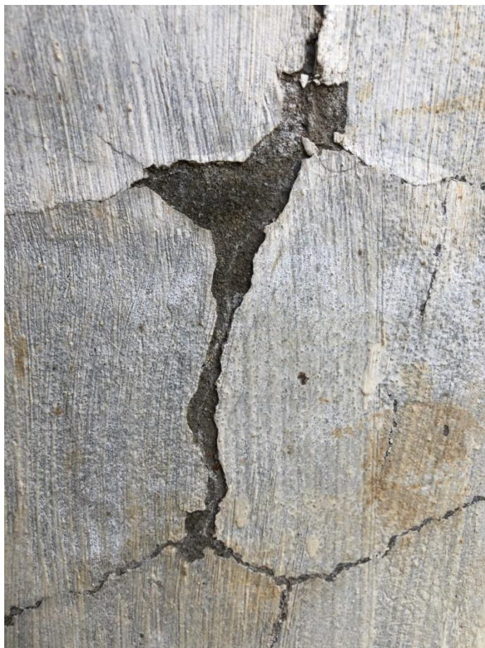
Figura 20 - Desplacamento na área externa da casa.
