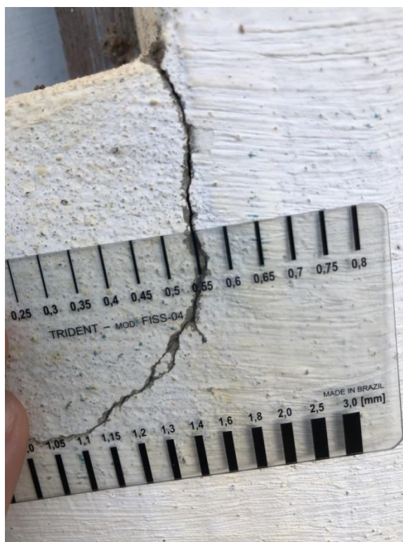
Figura 13 - Fissura ou trinca área externa.
