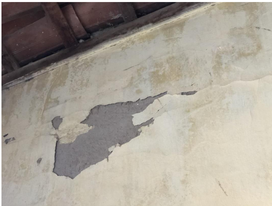
Figura 21 - Desplacamento na parte interna.
