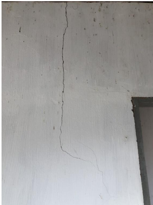
Figura 12 - Fissura ou Trinca área interna.
