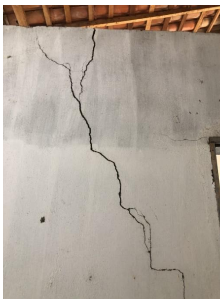
Figura 11 - Rachadura área interna.
