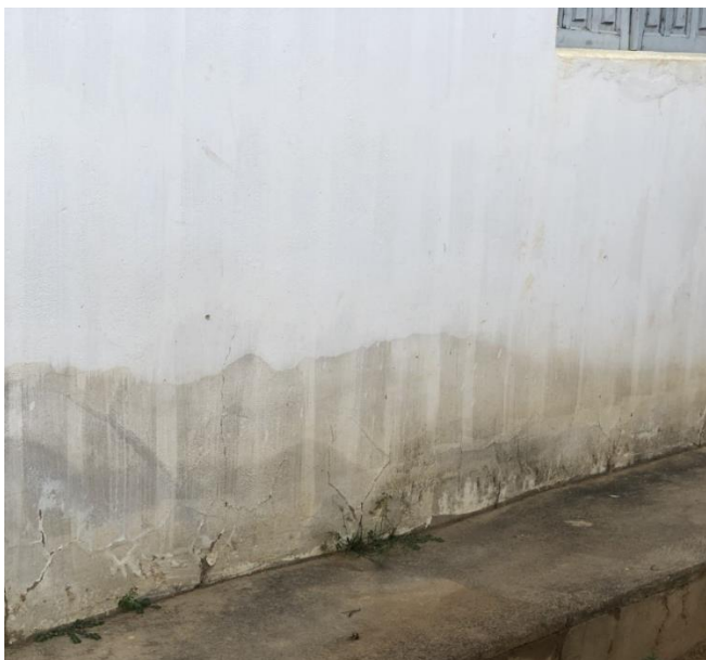
Figura 15 - Infiltrações área externa.
