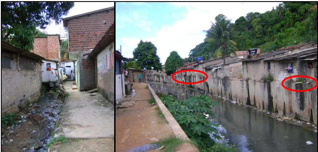
Figura 45: Lançamento de esgoto doméstico a céu aberto no Riacho do Reginaldo, Maceió – 2010
