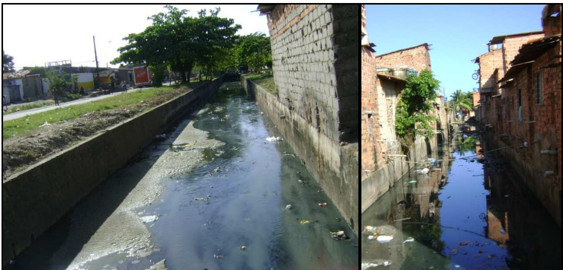
Figura 38: Canal no Vergel do Lago com margens invadidas e lançamento de esgoto domiciliar, Maceió – 2010
