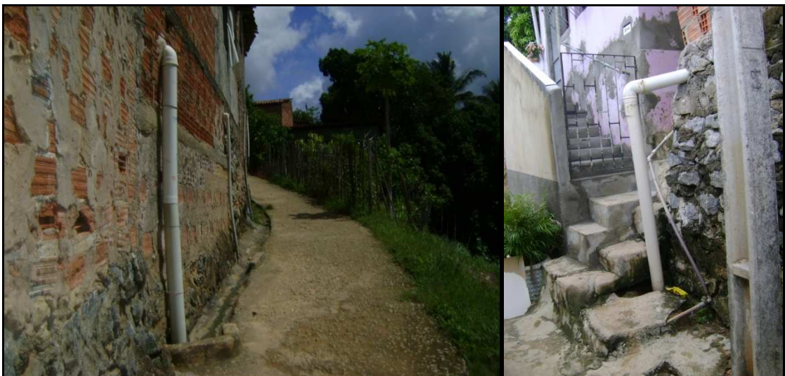
Figura 52: Tubulação de esgoto direcionada para vales da região do Benedito Bentes, Maceió – 2011
