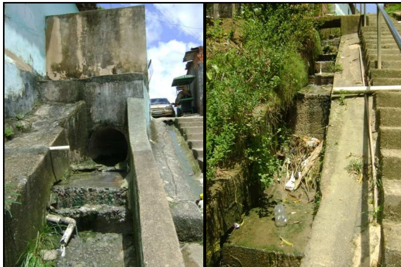
Figura 48: Esgoto a céu aberto em galeria de água pluvial e calhas superficiais no Benedito Bentes, Maceió – 2011
