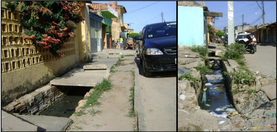
Figura 37: Valas de esgoto doméstico no Vergel do Lago, Maceió – 2010
