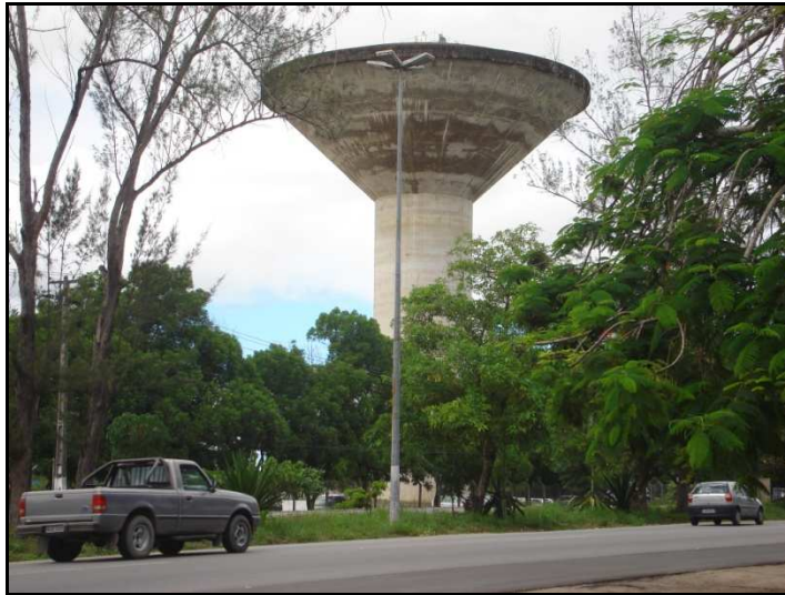
Figura 10: Reservatório d'água utilizado pelo sistema do Riacho Aviação
