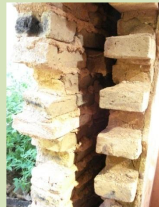
Figura 79 – Parede exterior de construção em ruína, alvenaria dobrada de tijolo de barro. Pilar. Fonte: Gabriella Peixoto, 2009.
