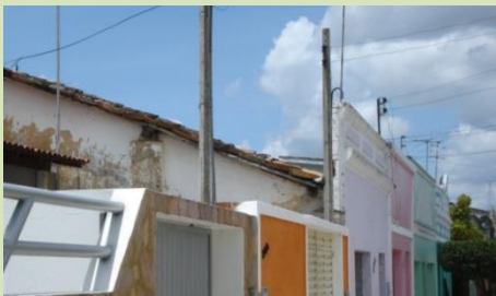
Figura 77 – Platibandas escondem os antigos telhados e forçam a incorporação de calhas. Fontes: Gabriella Peixoto, 2009.
