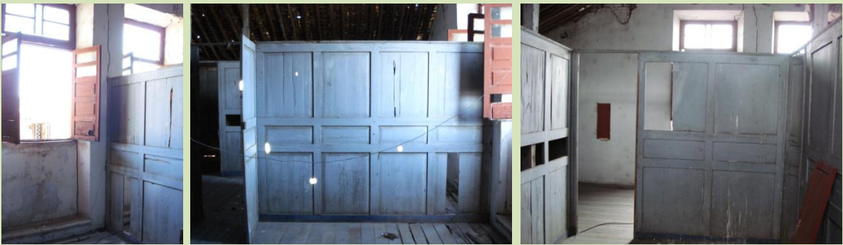
Quadro 16 – Vistas dos ambientes do sobrado: divisórias baixas e janelas proporcionam arejamento e iluminação abundantes. Fonte: idem.
