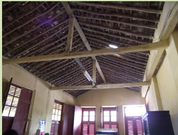
Figura 106 – A estrutura em madeira e as telhas canal da coberta. O desenho da esquadria e as folhas de escuro que possuem. Fonte: idem.
