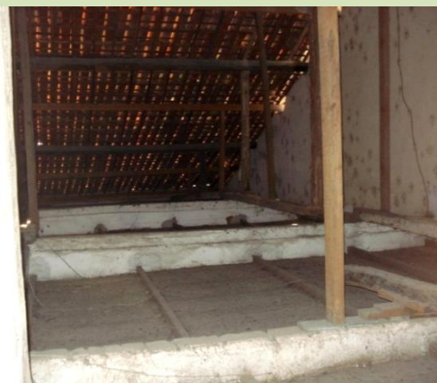
Figura 136 – Técnica construtiva do telhado. Vemos também que as paredes não o alcançam. Fonte: Gabriella Peixoto, 2008.
