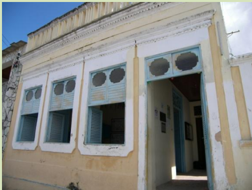
Figura 122 – Vista da entrada da Casa 4 com a sala de receber e o corredor. Fonte: Gabriella Peixoto, 2008.
