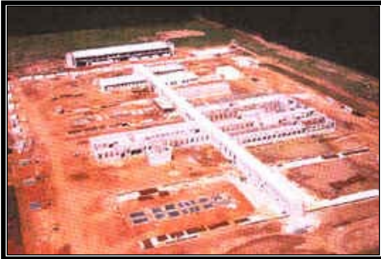
Figura 6: Foto de construção da Penitenciária de Itirapina/SP. Fonte: arquivos de relatório de obras do DEPEN/MJ (2002).
