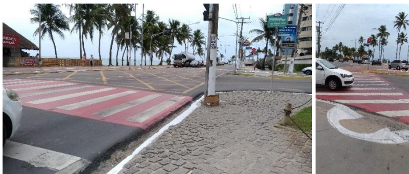
Figura 57 - À esquerda, travessia com sinal sonoro no trecho 1 e, à direita, rampa no trecho 2b
