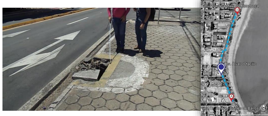
Figura 65 - Caixa de visita quebrada causando perigo ao voluntário
