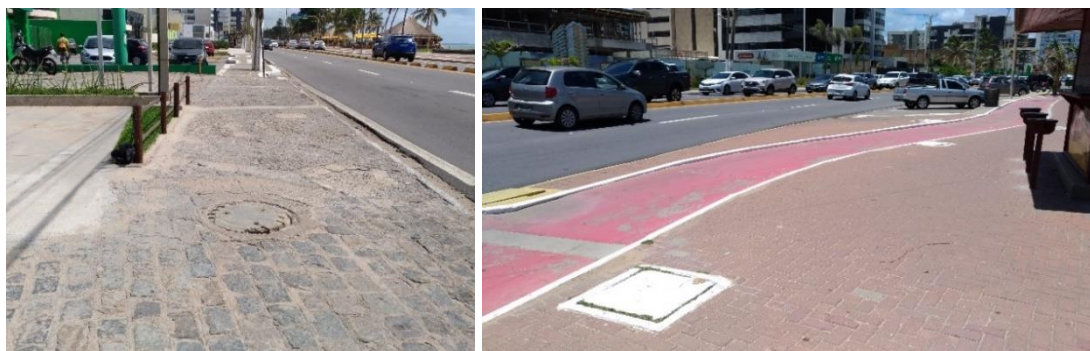
Figura 59 - Caixas de inspeção nos segmentos 2b (à esquerda) e 4b (à direita)
