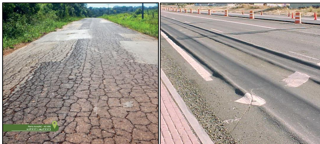
Figura 4.12- Pavimento com dano ruptura estrutural e ruptura funcional
