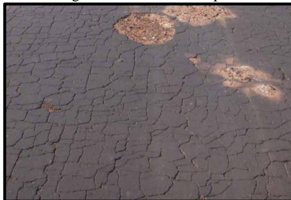
Figura 4.13- Fadiga do revestimento do pavimento asfáltico
