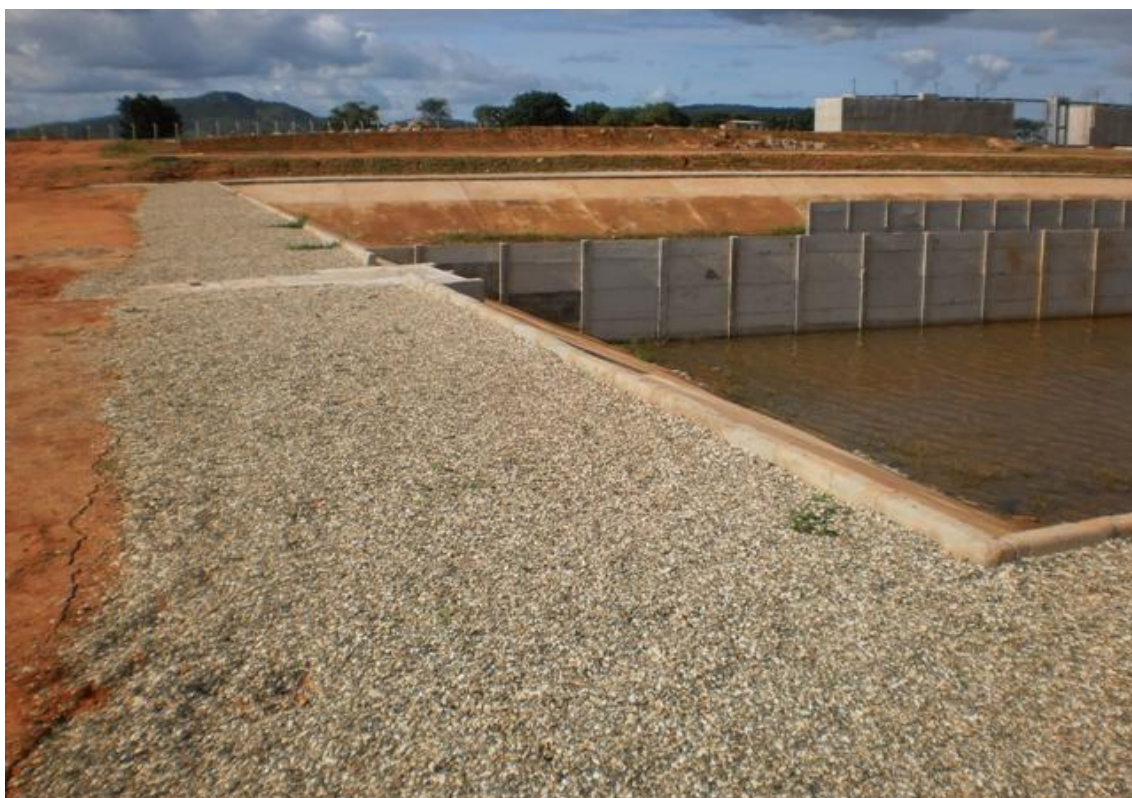
Figuras 13 – Estação de tratamento
