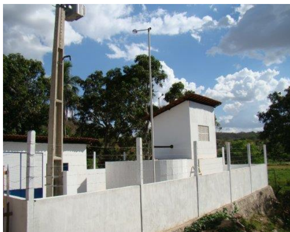
Figuras 11 – Estação elevatória
