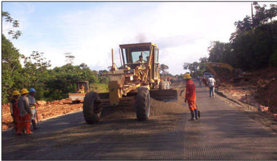
Figura 8 - Aplicação de base granular sobre geogrelha bidirecional na construção da Rodovia Iquitos. Fonte: Centurión et al (s. d.).
