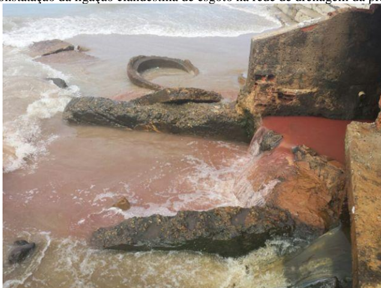
Figura 6: Constatação da ligação clandestina de esgoto na rede de drenagem da praia da Jatiúca.
