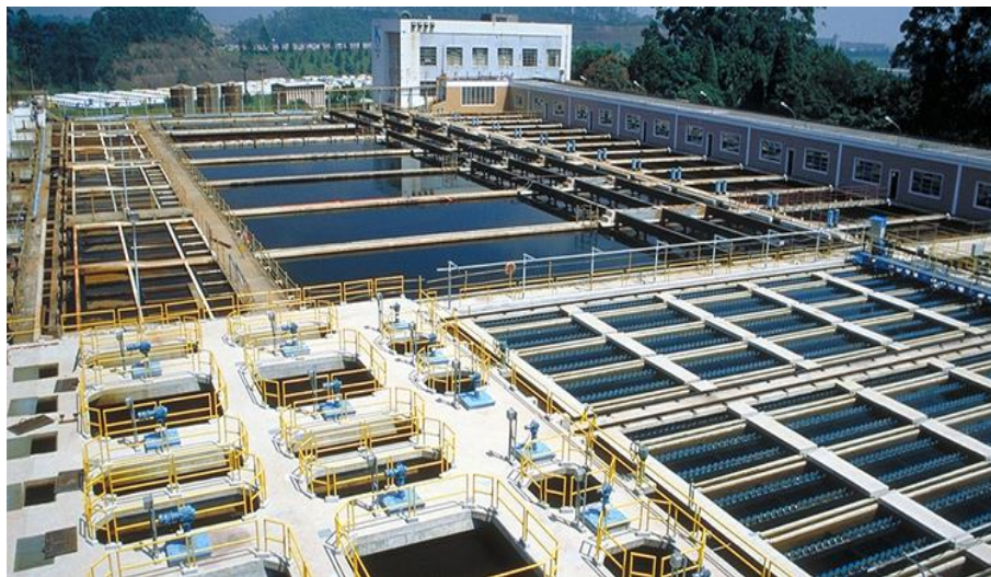
Figura 10 - Estação de tratamento de água – ETA.
