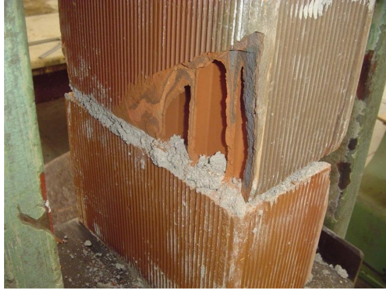
Figura 3.21 - Exemplo de um prisma 100.20 após ruptura.
