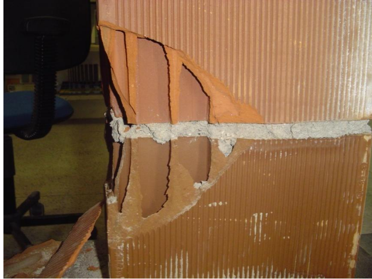
Figura 3.20 - Exemplo de um prisma 100.15 após ruptura.
