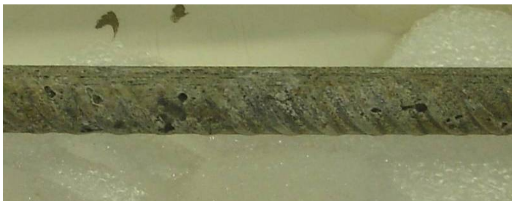
Figura 5.42 – Detalhe da barra após a retirada dos produtos de corrosão. Notem-se as pequenas cavidades provocadas pelas reações de corrosão.
