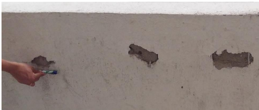
Figura 32: Descolamento da argamassa Fonte: Autor (2017)
