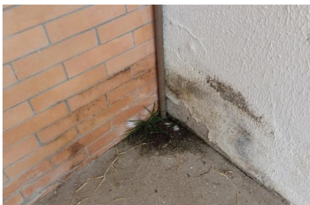
Figura 26: Mofos e bolores, parede externa da edificação Fonte: Autor (2017)
