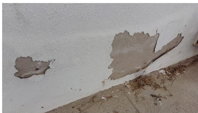
Figura 34: Desagregação da pintura, parede externa da edificação Fonte: Autor (2017)
