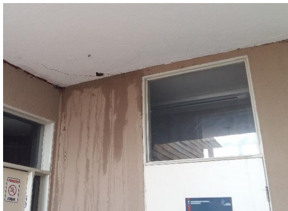
Figura 31: Manchas causadas por pingos de chuvas Fonte: Autor (2017)
