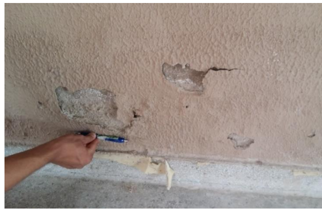
Figura 30: Deslocamento com empolamento da pintura Fonte: Autor (2017)
