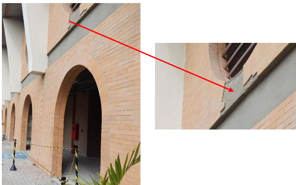
Figura 27: Área interna do campus isolada em ponto de descolamento do revestimento cerâmico Fonte: Autor (2017)
