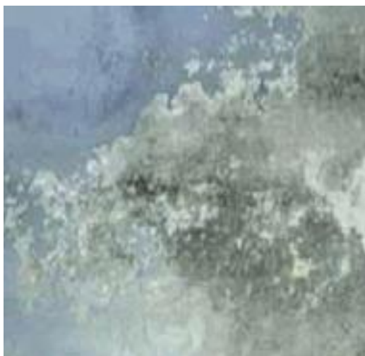
Figura 7: Eflorescência Fonte: empresa de tintas Real (2011)
