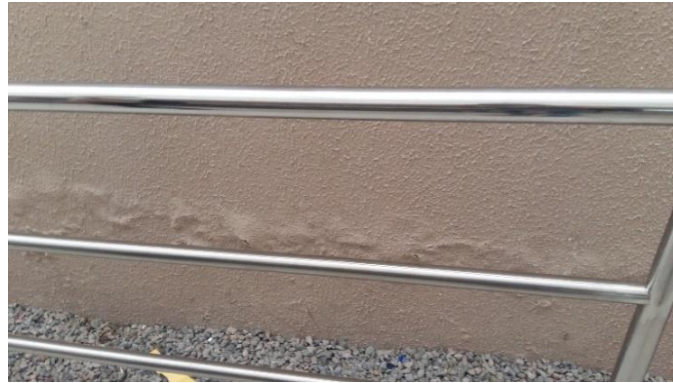
Figura 29: Empolamento da pintura Fonte: Autor (2017)
