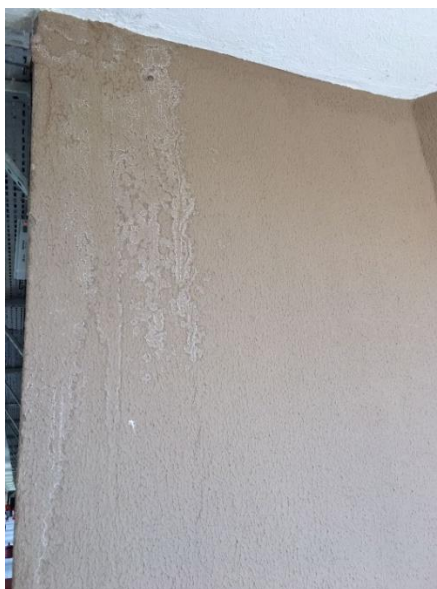
Figura 33: Eflorescência, parede interna da edificação Fonte: Autor (2017)
