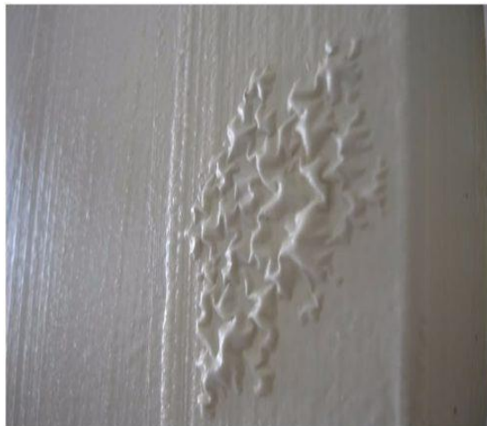
Figura 10: Enrugamento Fonte: empresa de tintas Real (2011)
