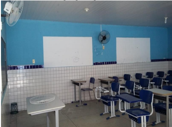
Figura 4 - Local de pesquisa: paredes onde haviam cobogós
