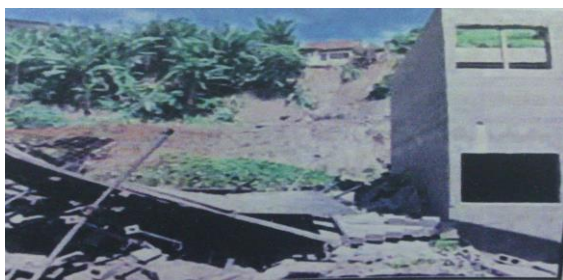
Figura 19: Prédios do Projeto de Revitalização do Vale do Reginaldo após deslizamento.
