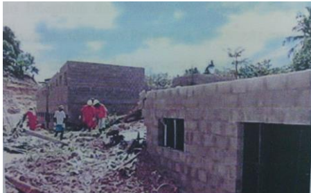
Figura 21: Trabalhadores recolhendo entulhos nas imediações do Projeto de Revitalização do Vale do Reginaldo atingido por deslizamento
