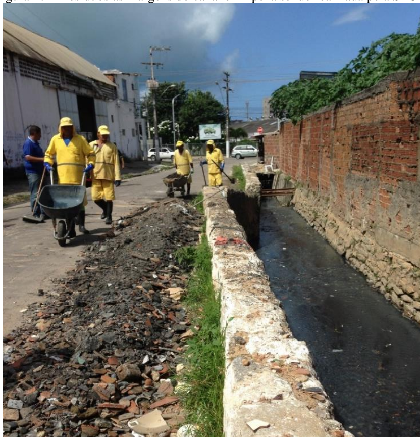
Figura 17 – Resíduos as margens do canal e limpeza sendo realizada pela SLUM.
