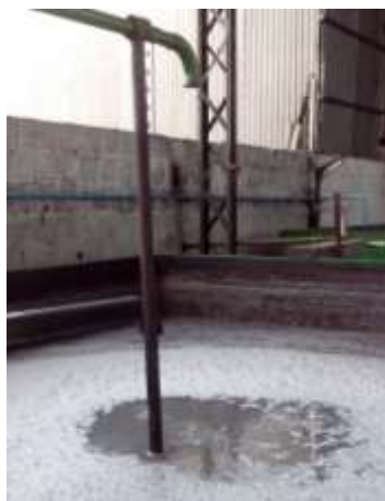
Figura 2 – Tanque de coleta do efluente do processamento industrial de coco.
