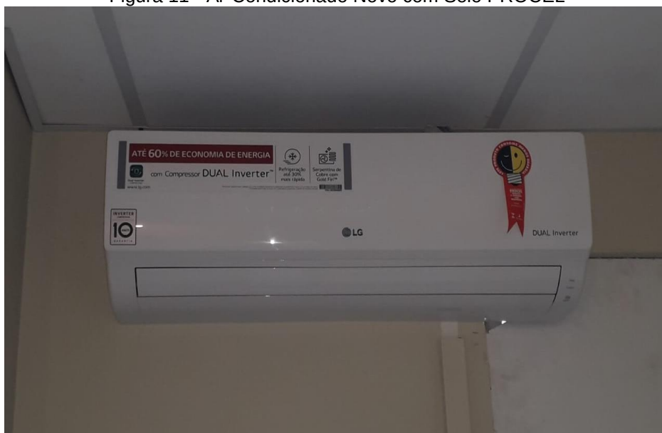
Figura 11 - Ar-Condicionado Novo com Selo PROCEL
