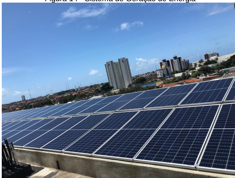
Figura 14 - Sistema de Geração de Energia
