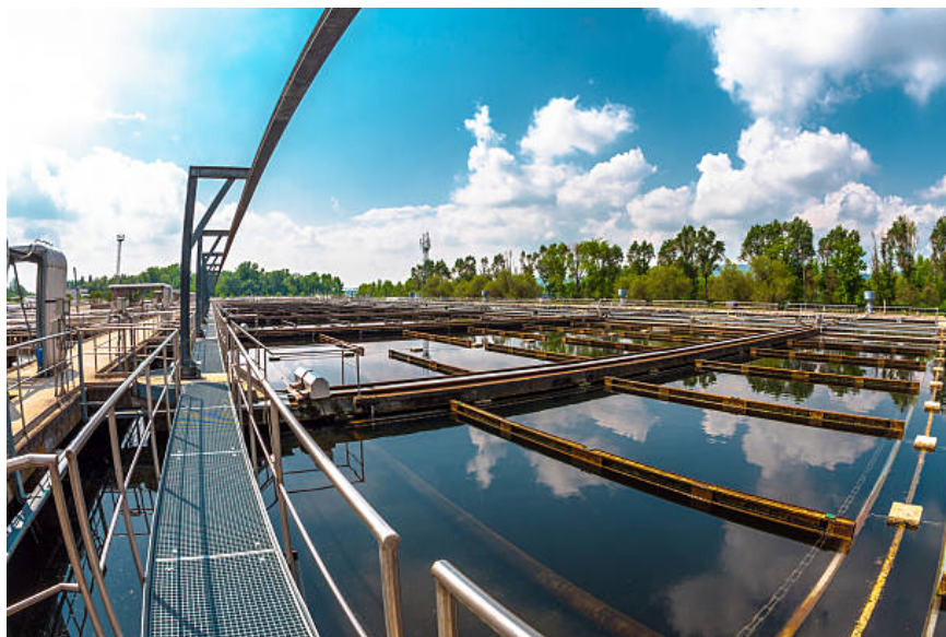
Figura 1. Estação de tratamento de esgotos
