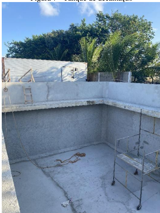
Figura 7 - Tanque de decantação
