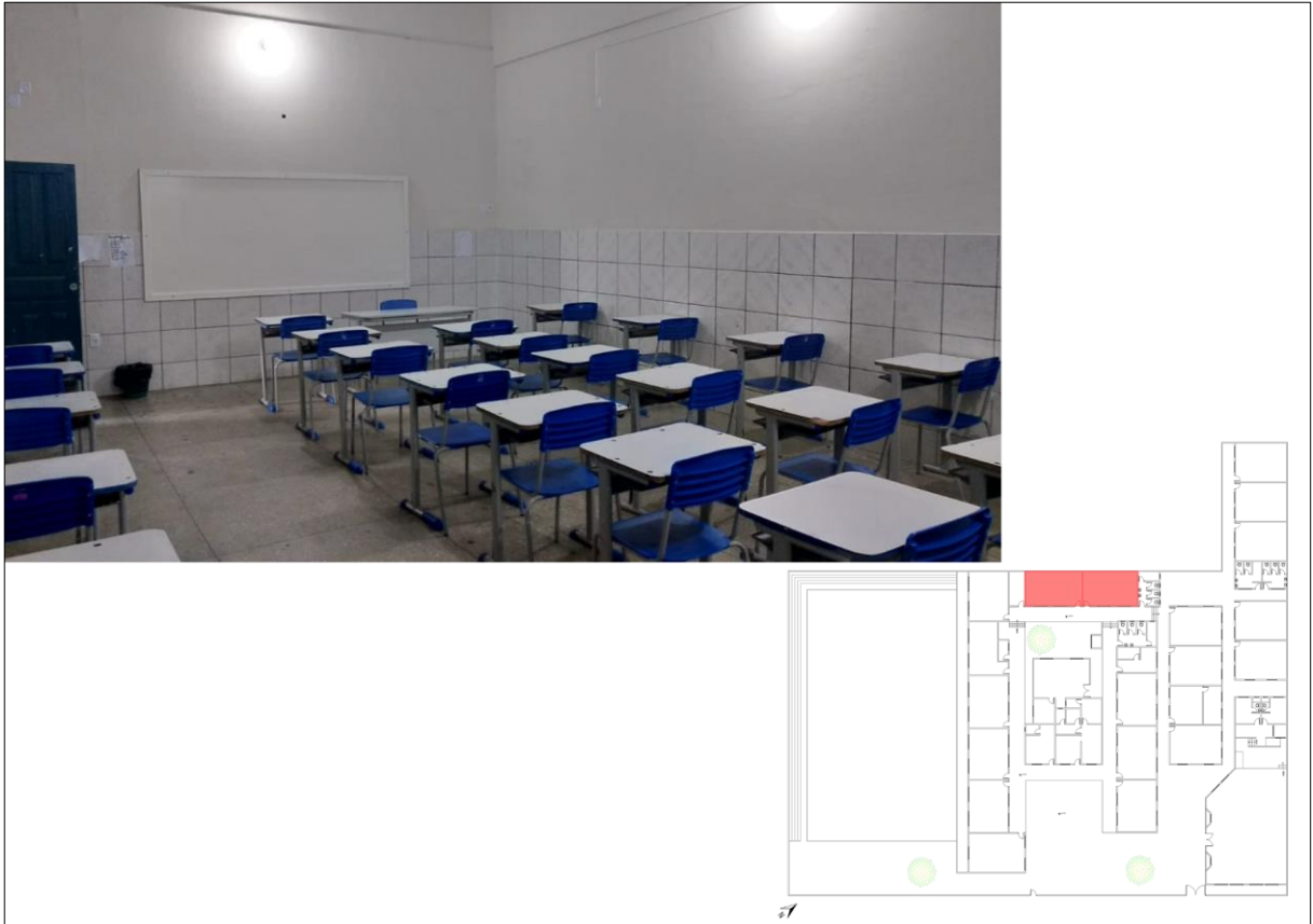
Figura 35 – Sala de aula com poucas janelas.
