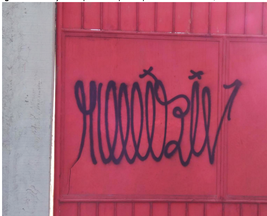
Figura 49 - Pixação em portão de prédio público. Santa Lúcia, R. Hélio Basílio.
