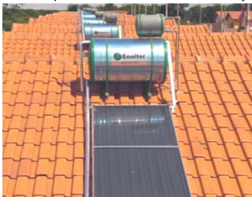
Figura 24 - Sistema de aquecedores solares em habitações de Itápolis/SP.
