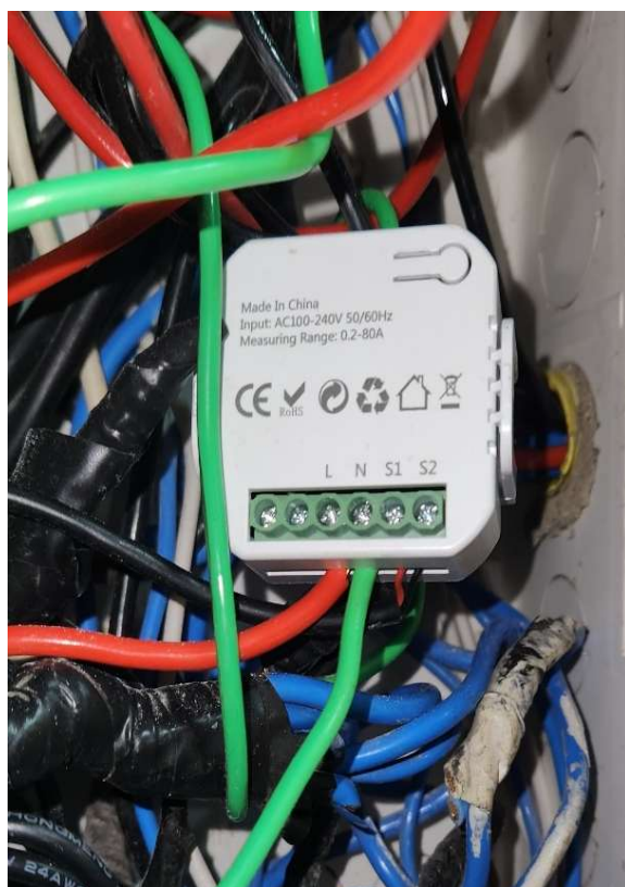
Figura 12 – Medidor monofásico instalado
