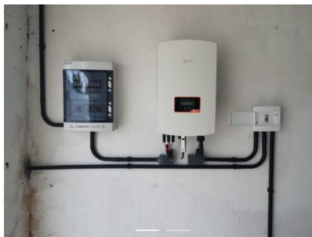
Figura 5 – Sistema 1: inversor String
