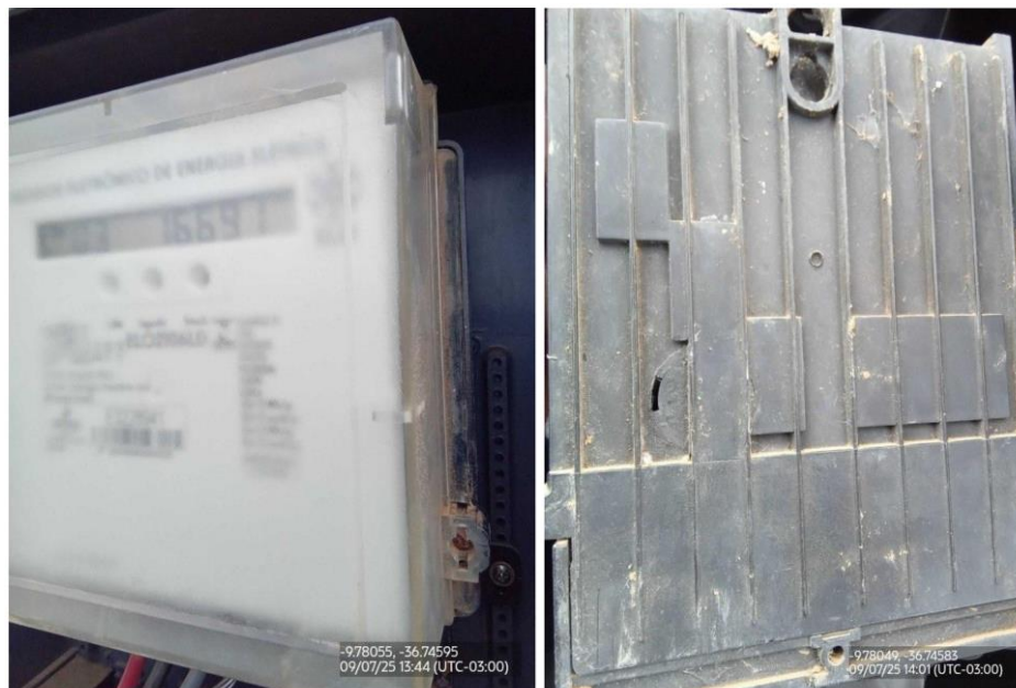
Figura 9 - Identificação da ausência do selo e lacre no medidor e na tampa.
