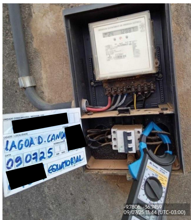
Figura 10 - Medição da passagem de corrente nas conexões.
