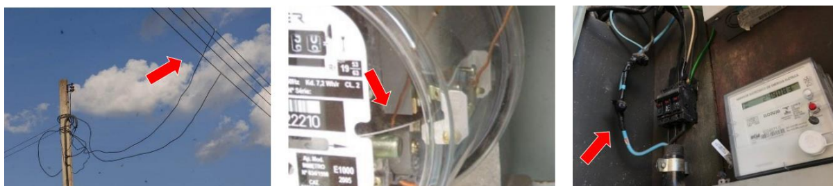
Figura 5 - Registros de exemplos de furto de energia na rede elétrica.
