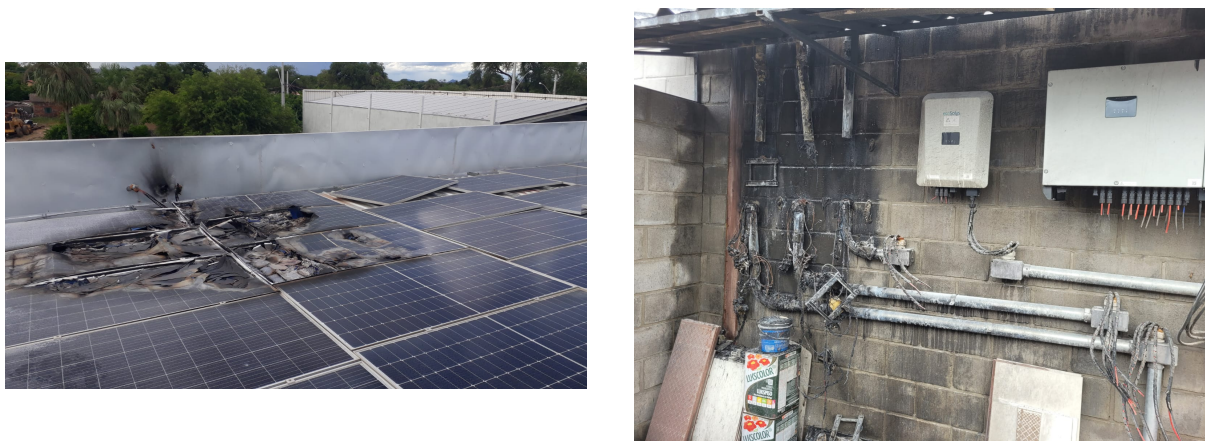
Figura 11 – Incêndio em sistema de energia solar fotovoltaica: módulos destruídos no telhado (esq.) e cabeamento e inversor carbonizados (dir.)
