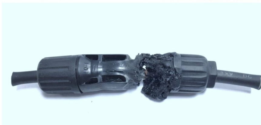
Figura 7 – Conector MC4 genérico destruído por fusão decorrente de crimpagem inadequada
