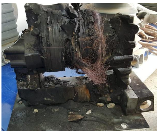
Figura 1 – Transformador de instrumento explodido após a atividade de DP.
