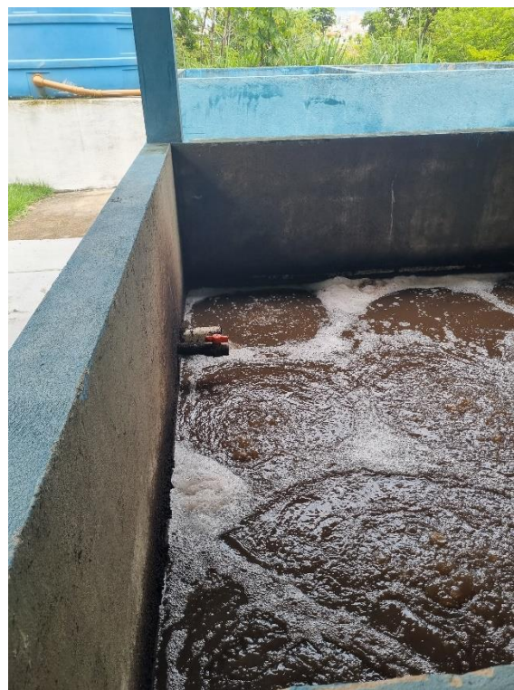
Figura 14 - Tanque de aeração.
