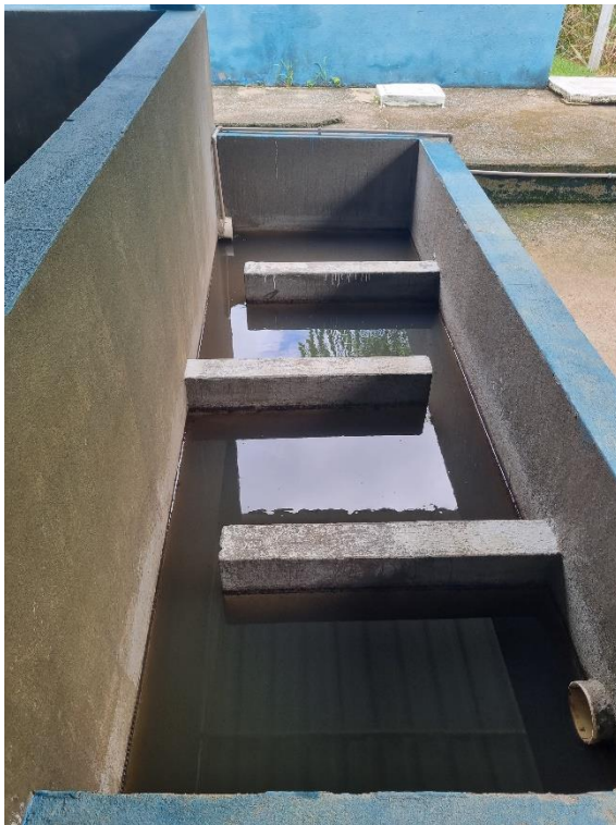
Figura 17 - Tanque de contato.
