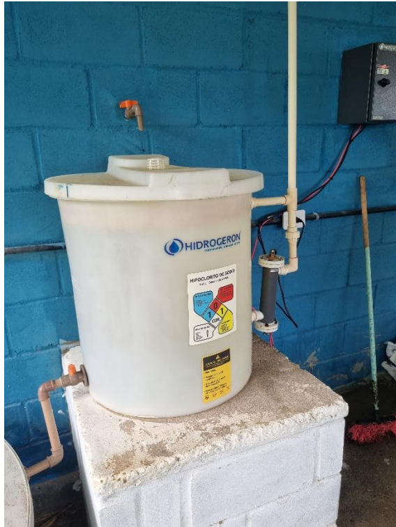
Figura 19 - Tanque de armazenamento de cloro.
