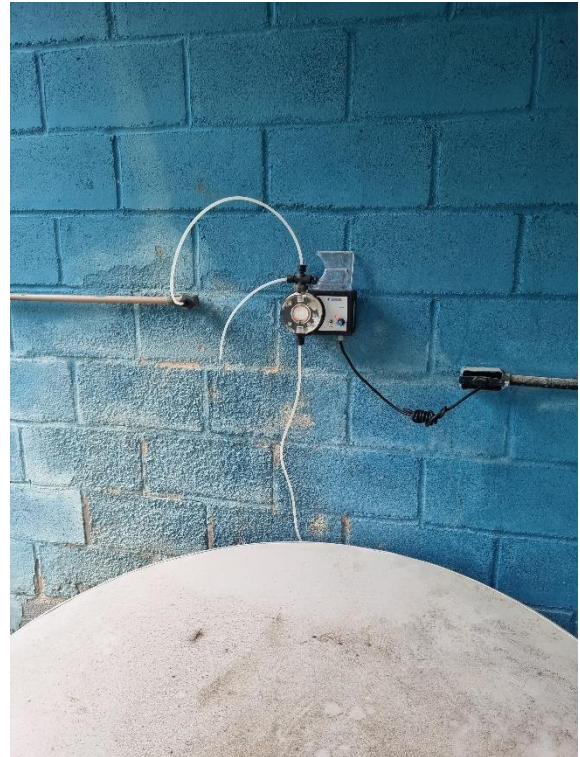
Figura 20 - Bomba dosadora de cloro.
