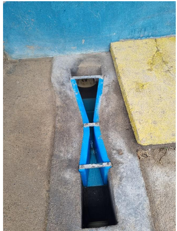
Figura 18 - Calha Parshall para efluente tratado.
