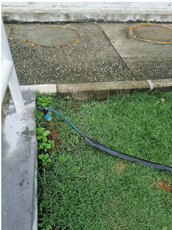
Figura 11 - Torneira de alimentação para irrigação.
