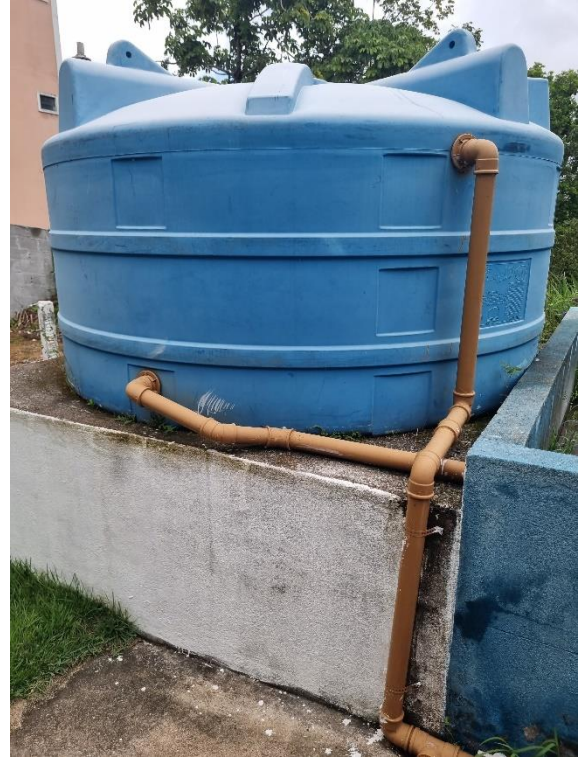
Figura 16 - Tanque de armazenamento de lodo.
