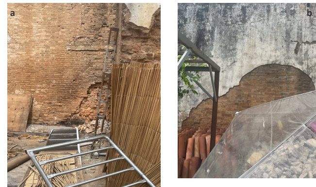
Imagens 22 (a, b, c e d) - Patologias presentes nas paredes remanescentes
