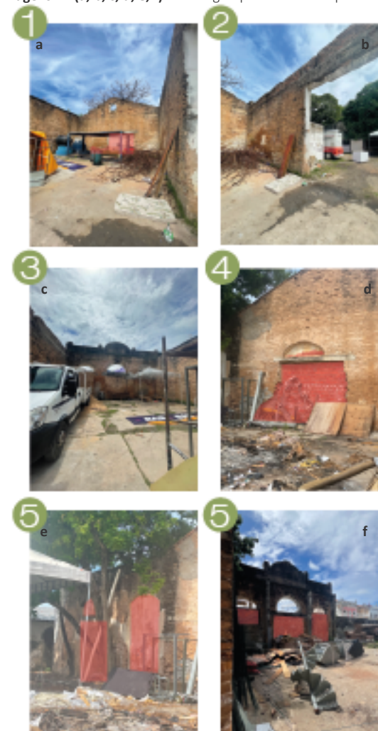
Imagens 21 (a, b, c, d, e, f) - Patologias presentes nas paredes remanescentes
