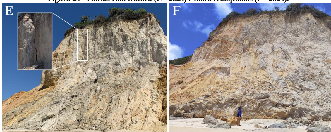
Figura 29 - Falésia com fratura (E - 2023) e blocos colapsados (F - 2024).
