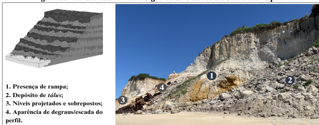
Figura 33 - Falésia escalonada e algumas características evidentes no perfil.
