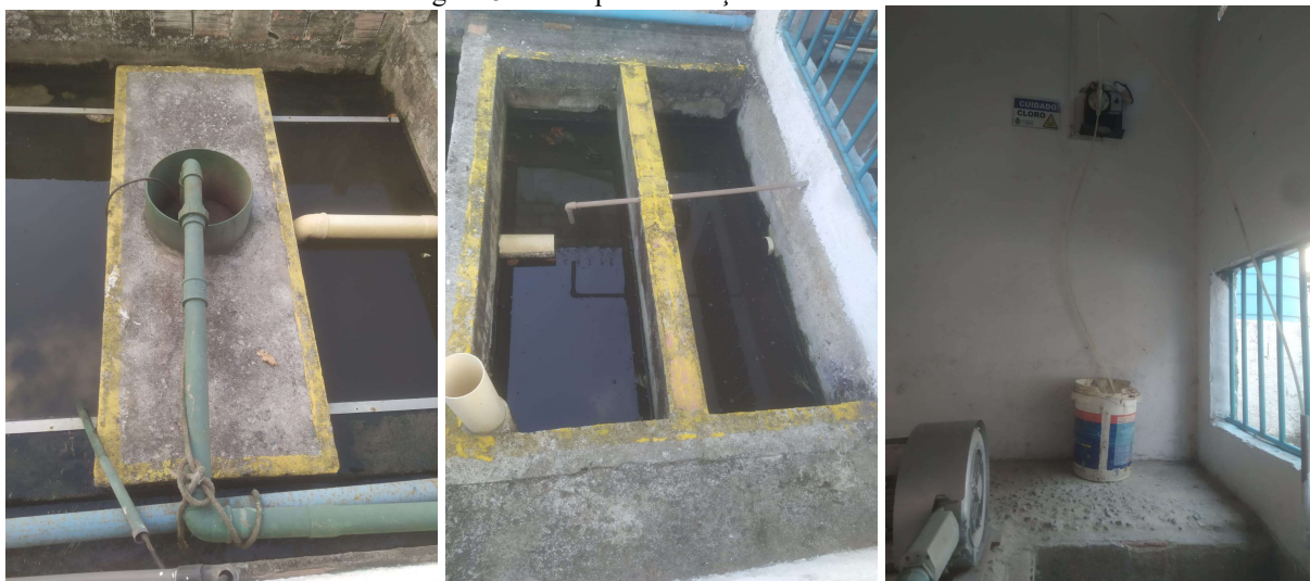
Figura 5.3. Decantador secundário, câmara de contato, soprador de ar e bomba dosadora.
