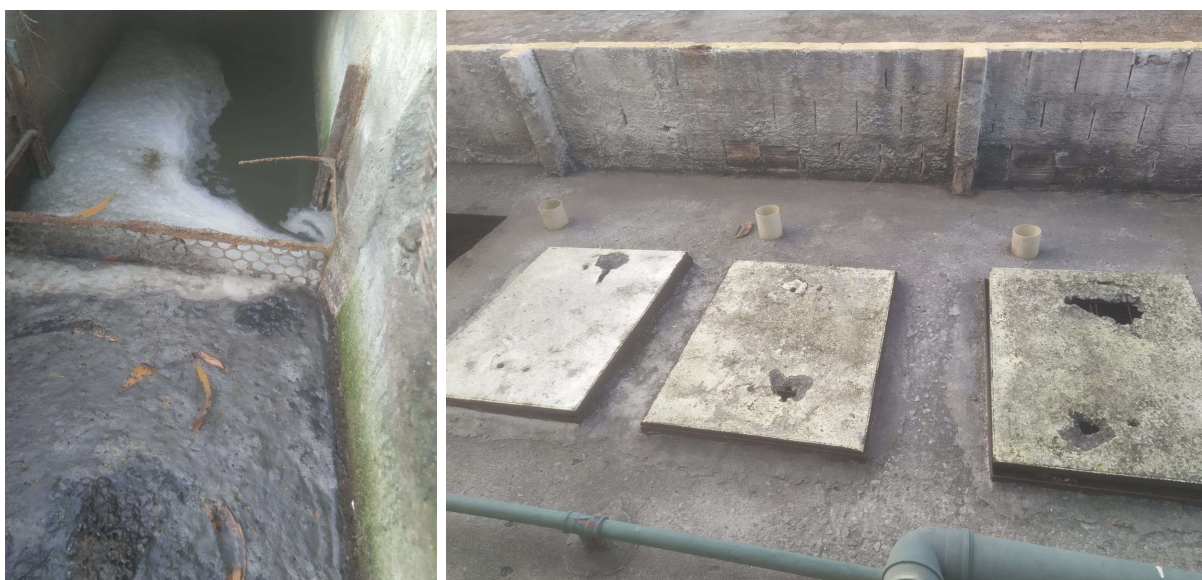
Figura 5.1 Canal de chegada com grade e reator anaeróbio de chicanas. Fonte: autora (2022)
