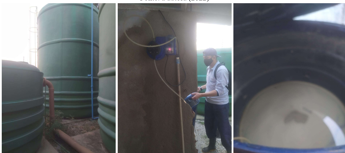
Figura 5.7. Tanque de lodo ativado, bomba dosadora e tanque de contato. Fonte: a autora (2022)
