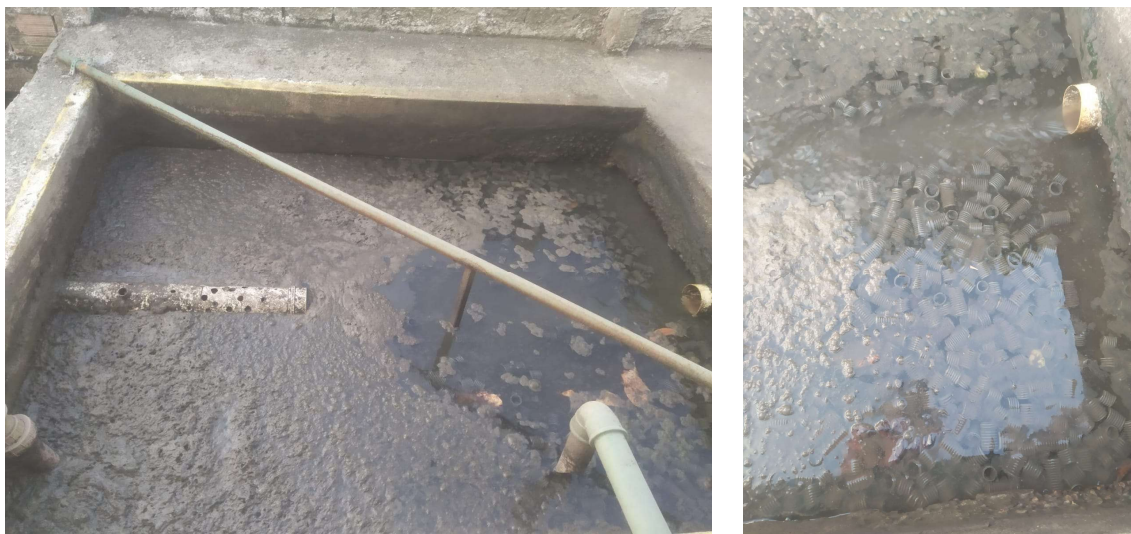
Figura 5.2. Tanque de aeração com MBBR.
