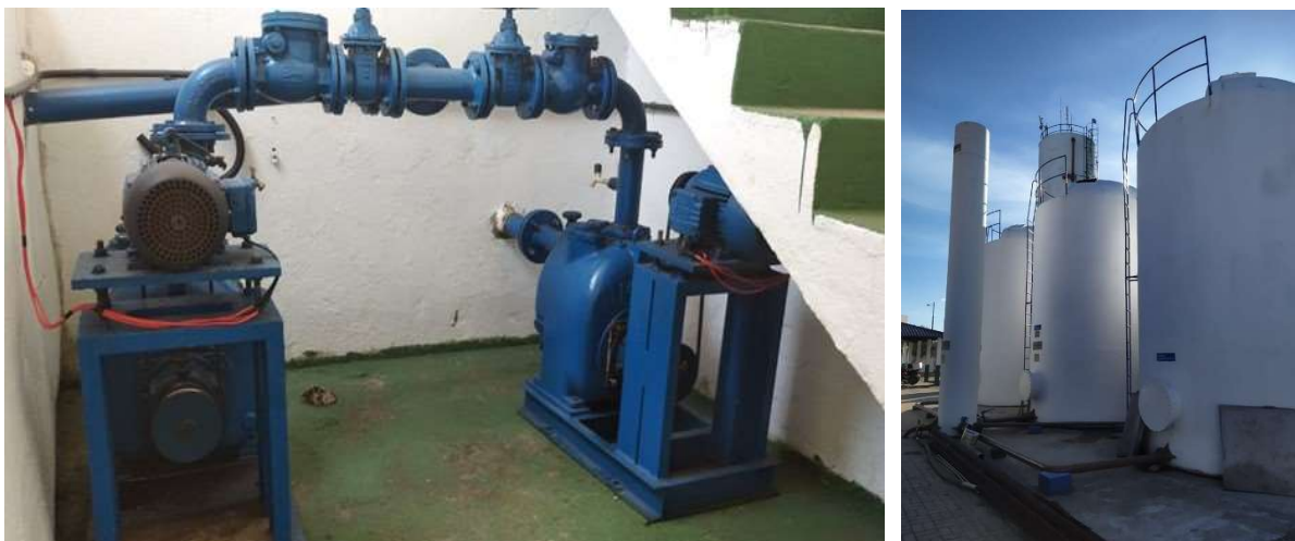
Figura 5.8. Bombas da elevatória e caixa de divisão de vazão e reatores UASB. Fonte: a autora (2022)
