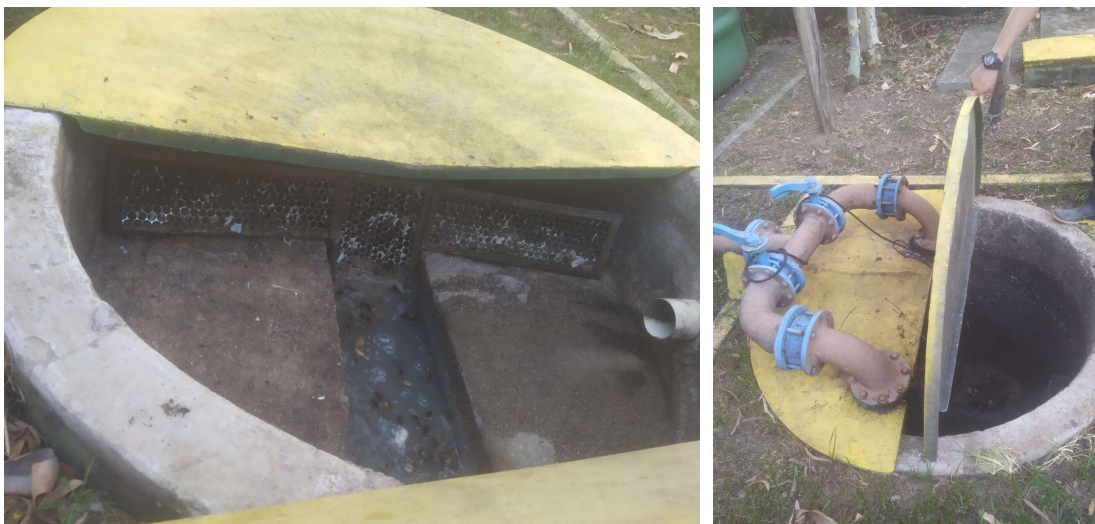
Figura 5.5 Canal de chegada com grade e elevatória de esgoto pré-tratado. Fonte: a autora (2022)
