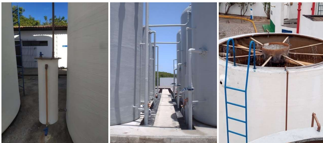
Figura 5.9. Selo hidráulico do UASB, canal de descarga de lodo e distribuição de vazão no filtro percolador. Fonte: a autora (2022)
