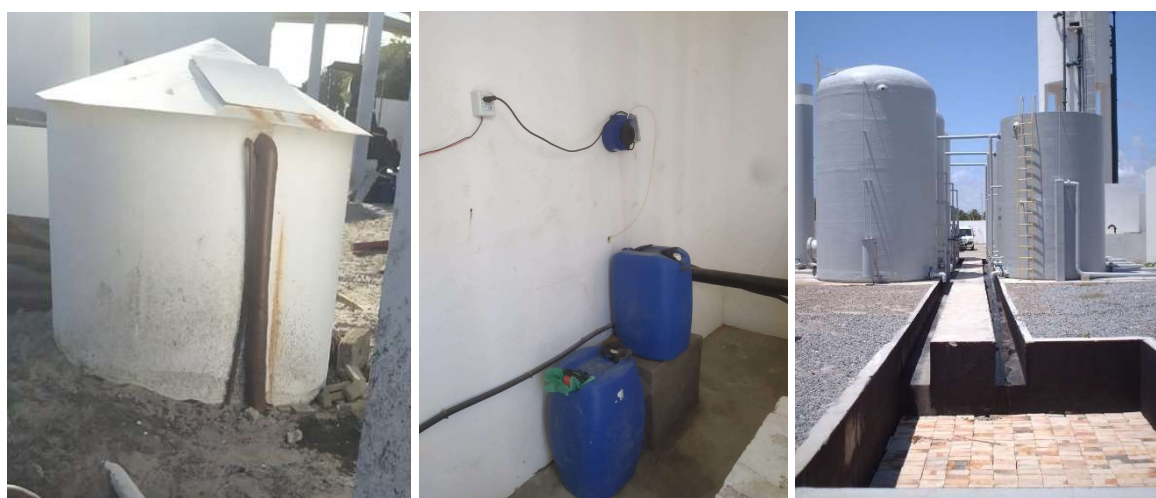
Figura 5.10. Tanque de contato, bomba dosadora e ETE com leito de secagem. Fonte: a autora (2022)
