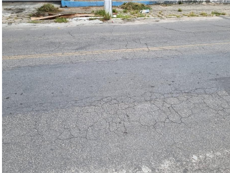
Figura 15: Trincas interligadas tipo couro de jacaré e remendo.
