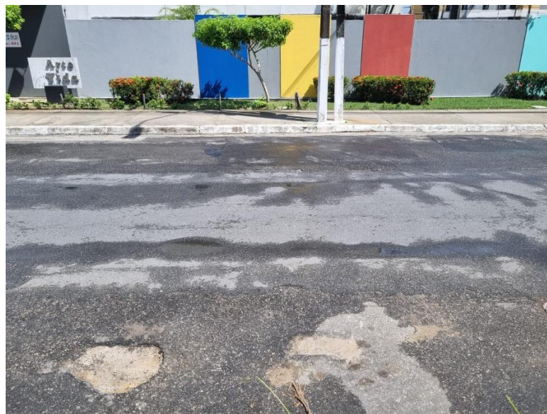
Figura 16: Panela, afundamento e desgaste.
