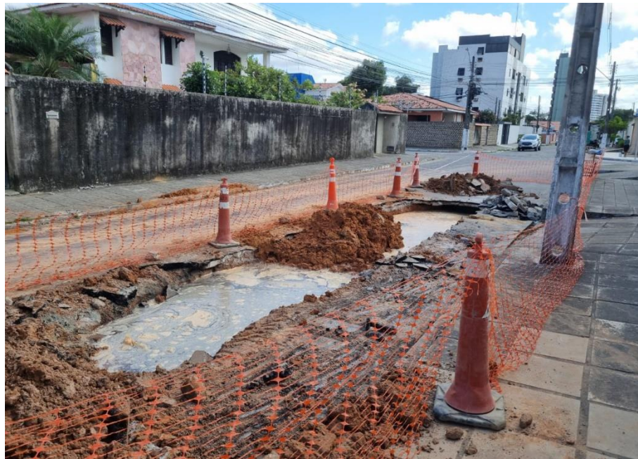
Figura 18: Vazamento da rede coletora de esgoto em outubro de 2024.
