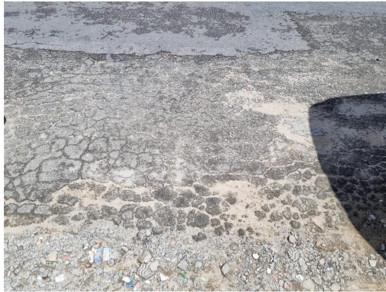
Figura 17: Trincas interligadas tipo couro de jacaré com erosão.
