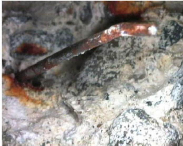
Figura 8 - Fibra de aço corroída na fissura do concreto
