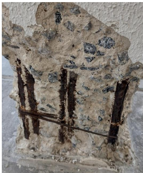
Figura 34 – Corrosão dos estribos e armaduras longitudinais
