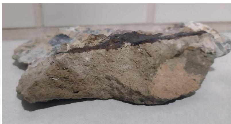
Figura 27 – Ensaio de carbonatação do pilar 9 do bloco 2
