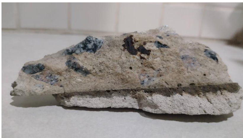
Figura 31 – Ensaio de carbonatação do pilar 20 do bloco 5
