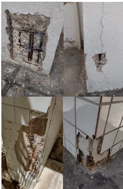
Figura 13 – Análise visual dos pilares de concreto com sinais de deterioração
