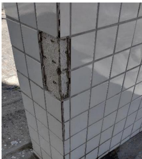
Figura 5 – Descolamento da argamassa ao substrato das pastilhas presentes em pilares em concreto armado
