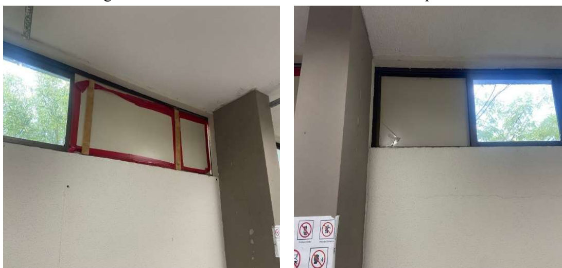
Figura 9 – Janela com dificuldade de abertura e vidro quebrado.
