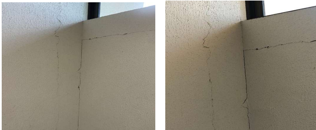
Figura 5 - Patologias nas paredes da biblioteca.
