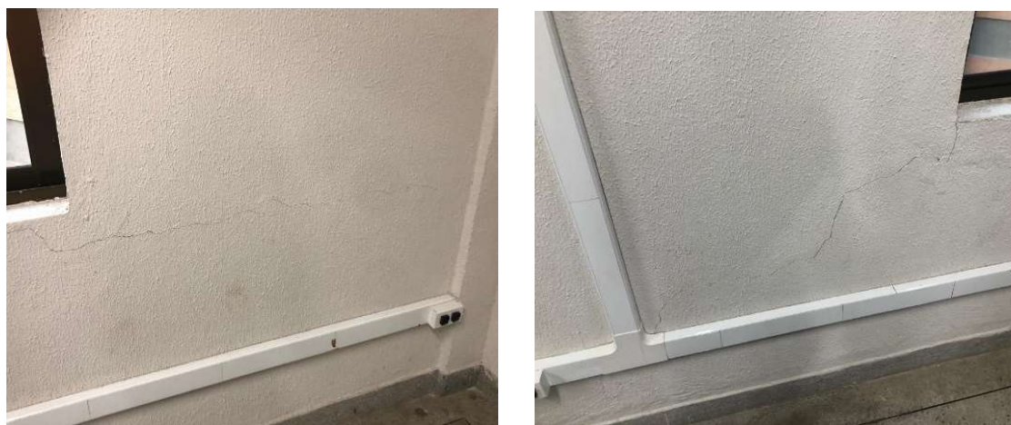
Figura 6 - Patologias causada pela falta de vergas e contravergas na biblioteca.
