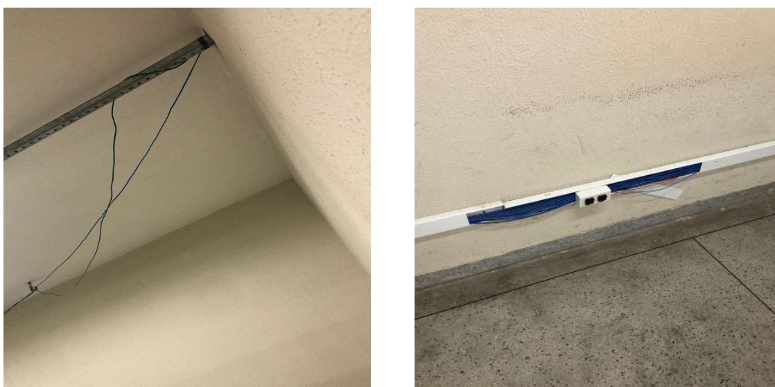
Figura 12 - Patologias identificadas na área de estudo coletivo.
