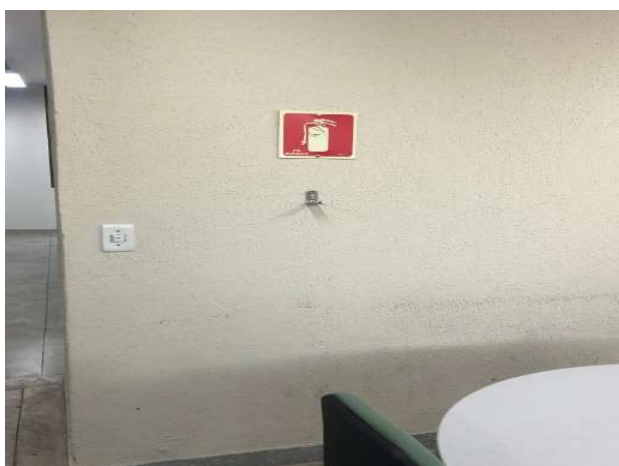
Figura 7 - Falta de equipamento de segurança para combate a incêndio (NBR – 12693).
