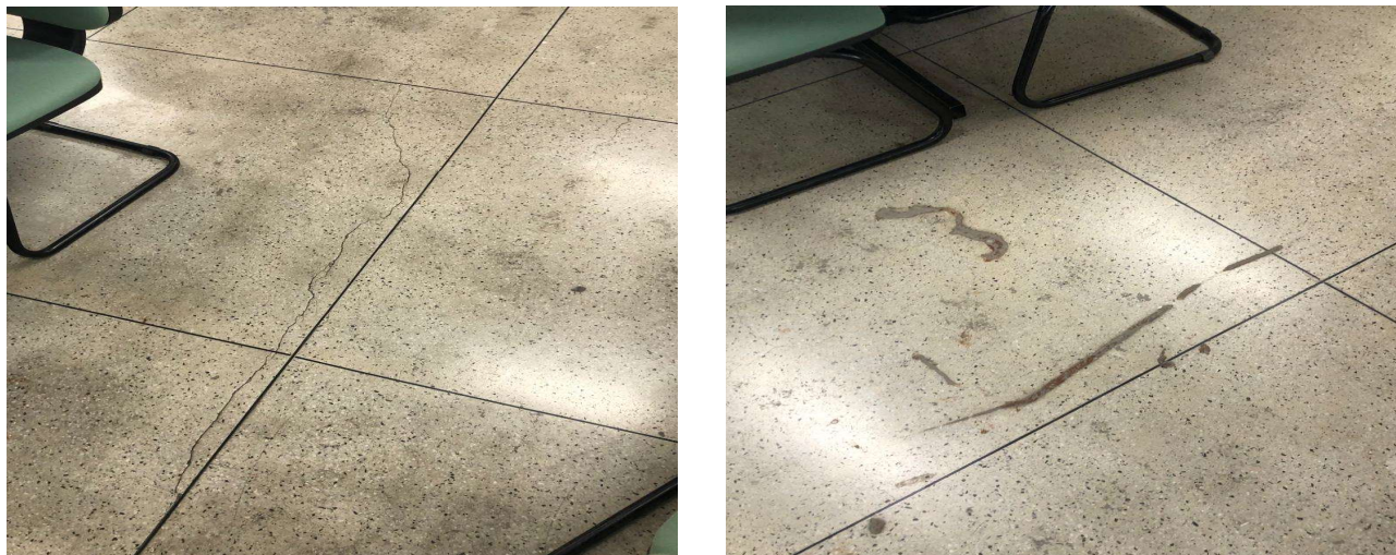
Figura 3 - Patologias identificadas no piso da área de estudo coletivo.
