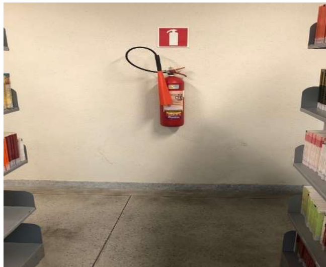
Figura 8 – Extintor próximo as áreas de circulação intensa e adjacentes (NBR – 12693).
