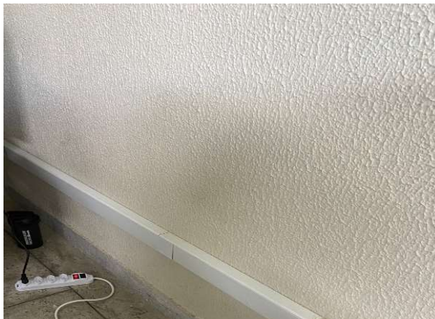
Figura 4 – Textura rustica no sentido vertical.
