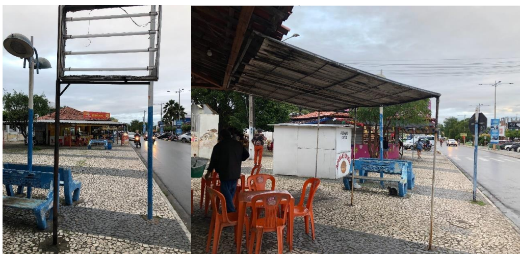
Figura 20: a) Placas de sinalização vertical localizada no espaço dedicado à faixa livre; b) “Puxadinho”; ambas no trecho 14.
