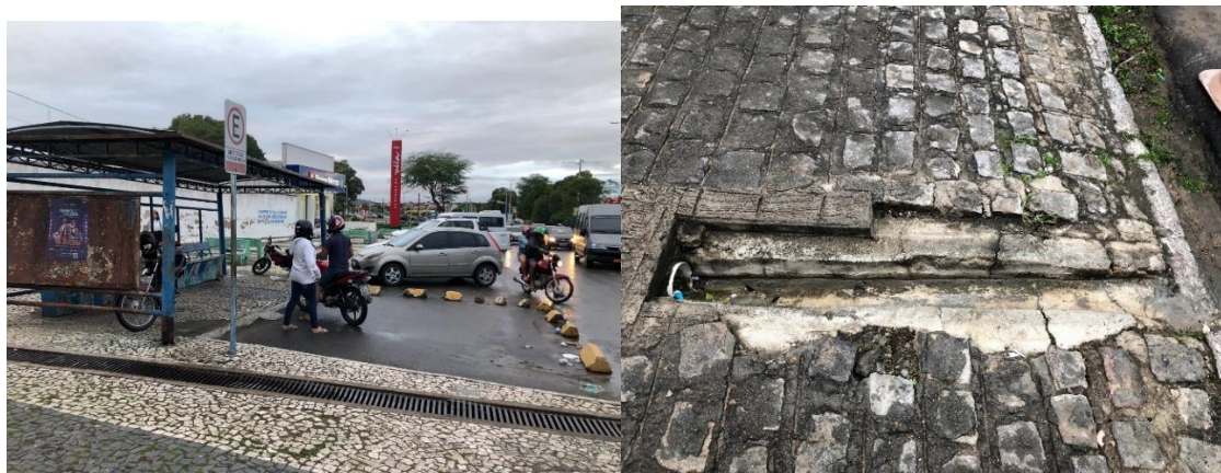
Figura 28: a) Vãos das grelhas com sentido de abertura transversal ao deslocamento no trecho 12; b) Ausência de grelha no trecho 17.
