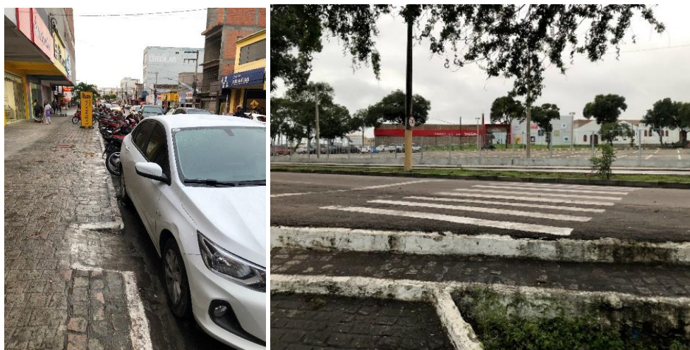
Figura 24: Ausência de rebaixo adequado para travessia de pedestres nos trechos 09 e 12.
