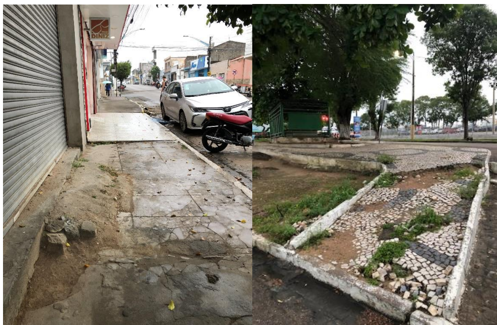
Figura 22: Pisos necessitando de manutenção nos trechos 02 e 11.
