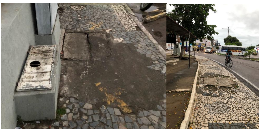
Figura 27: Tampa de inspeção fora de conformidade nos trechos 05 e 09.
