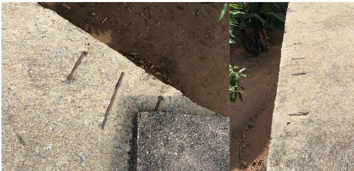
Figura 22: Zonas de corrosão ao longo da superfície do reservatório vistoriado.
