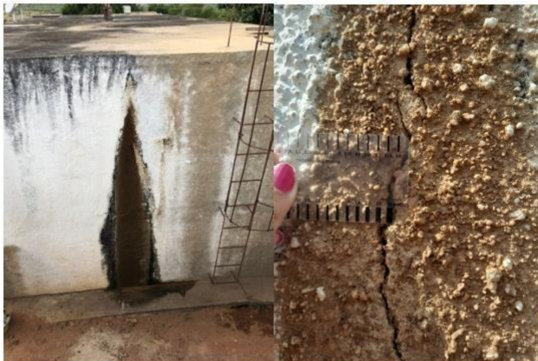
Figura 16: Rachadura e vazamento no reservatório analisado.
