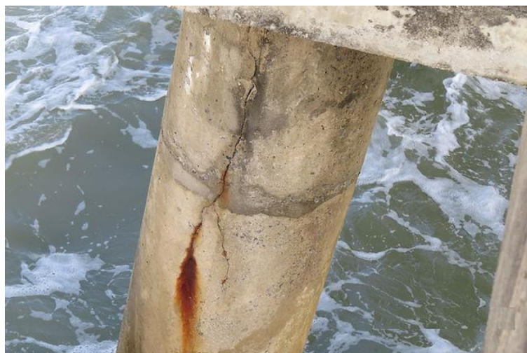
Figura 7: Indício de corrosão por cloreto em estrutura exposta à maresia.
