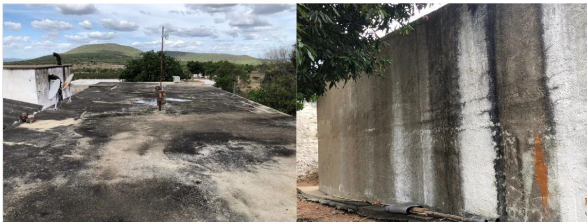
Figura 19: Manchas e eflorescência ao longo da edificação.
