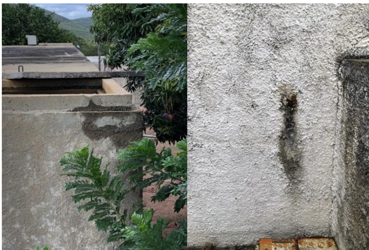
Figura 17: Umidade e infiltração na edificação analisada.
