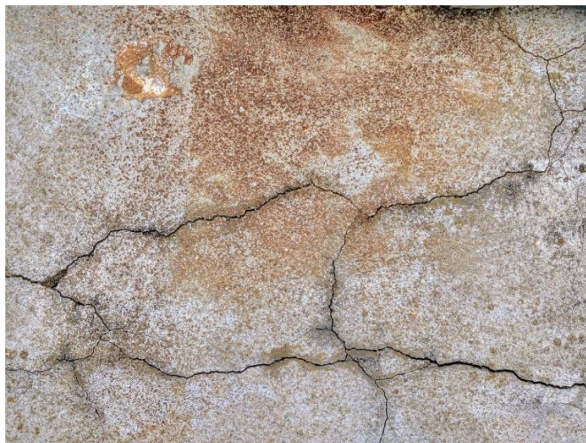
Figura 3: Trincas e fissuras em superfície de concreto.
