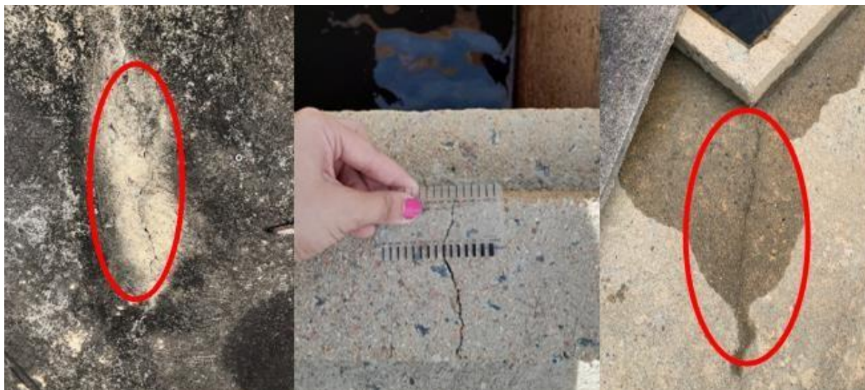
Figura 15: Fissura e rachadura presente da laje de cobertura do reservatório.
