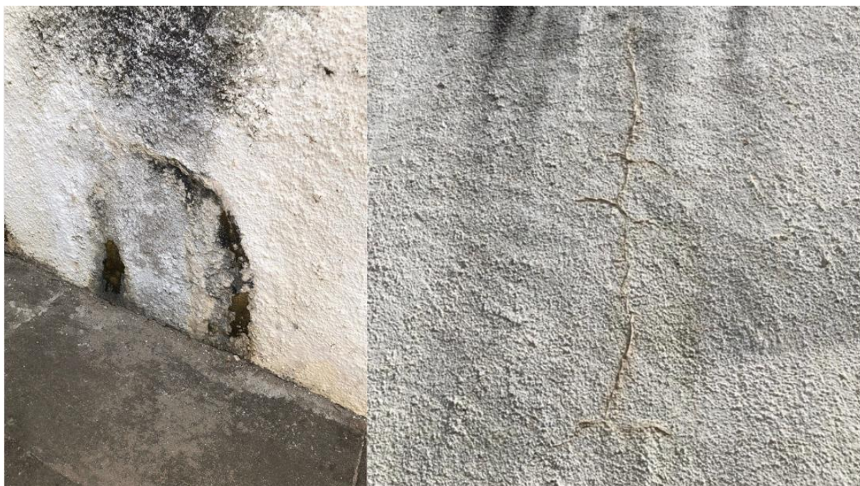
Figura 18: Infiltração e destacamento da pintura
