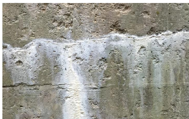
Figura 6: Indício de carbonatação em estrutura de concreto.
