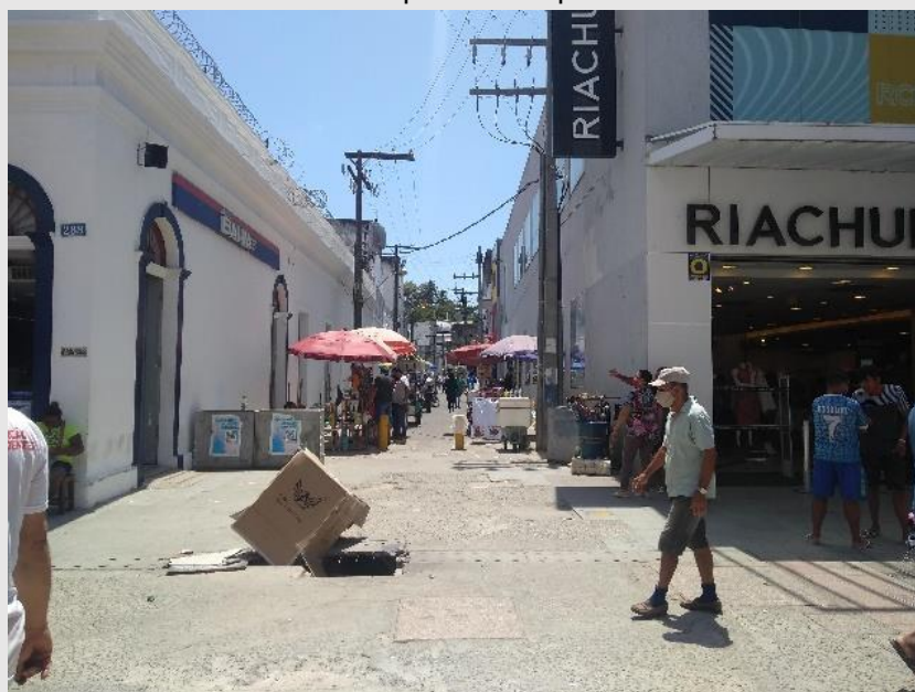
Imagem 93: Trecho 02 da Rua do Comércio, onde percebe-se um buraco no calçadão sinalizado por uma caixa de papelão e o desnível do piso ocasionado principalmente pela diferença de materiais e técnicas aplicadas no piso.
