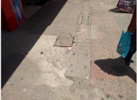
Imagem 100: Boca de lobo no calçadão da Rua do Comércio. Nota-se parte do calçadão danificado.
