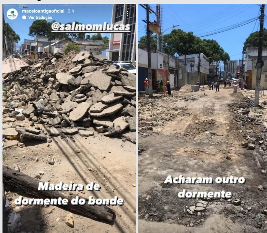
Imagem 129: Registros dos dormentes encontrados abaixo do asfalto na Rua da Alegria.
