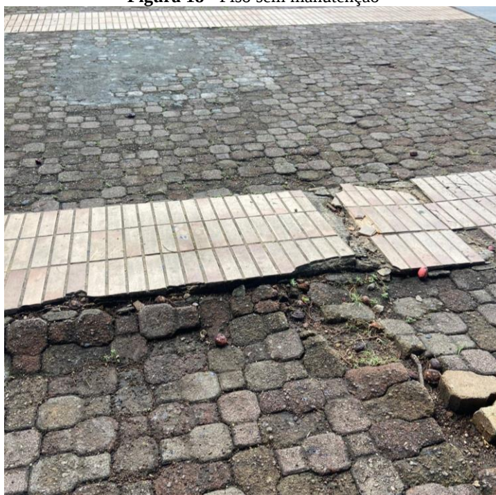
Figura 18 - Piso sem manutenção
