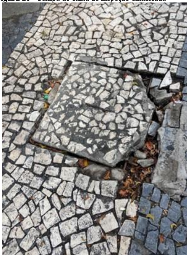
Figura 26 - Tapa de caixa de inspeção danificada
