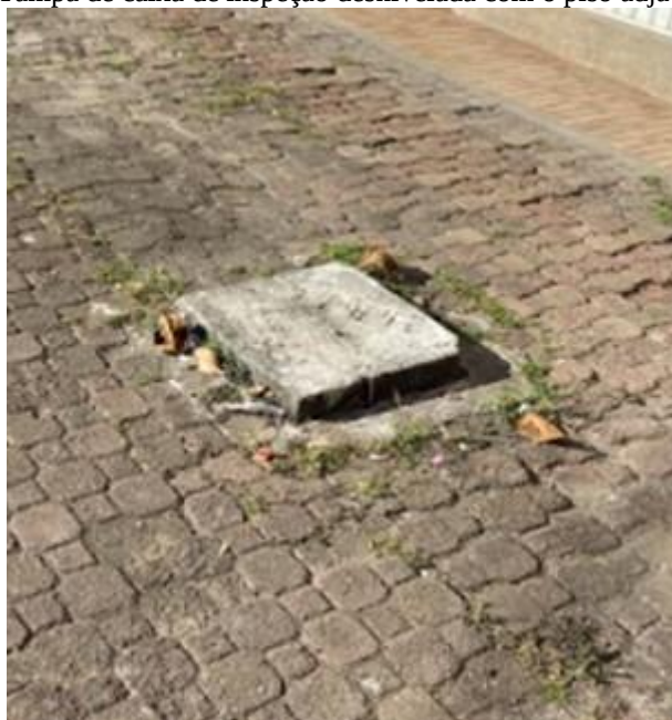
Figura 25 - Tapa de caixa de inspeção desnivelada com o piso adjacente
