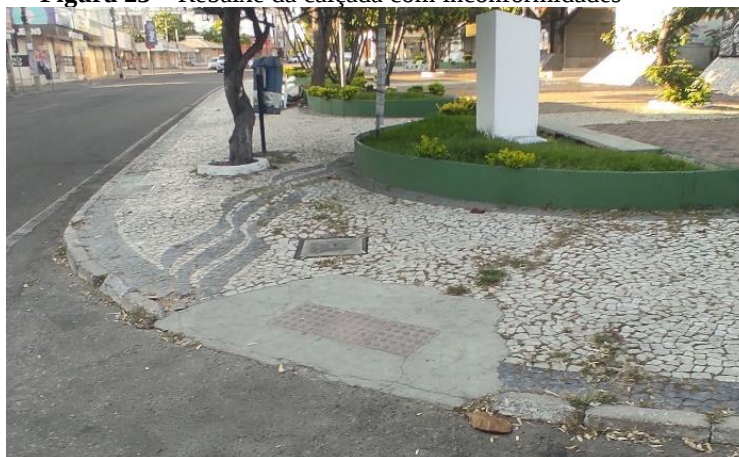
Figura 23 – Rebaixe da calçada com inconformidades
