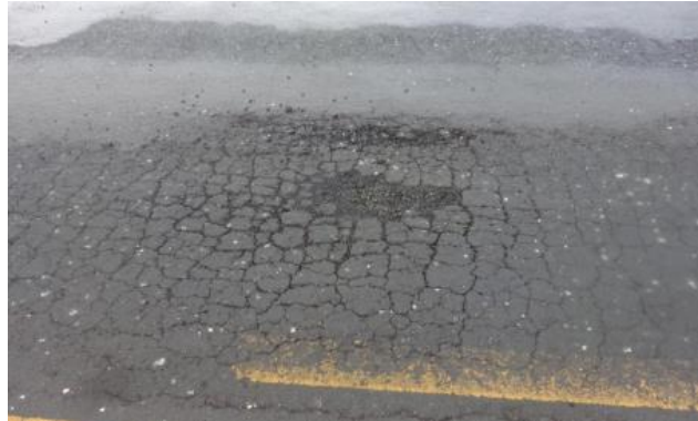
Figura 14: Trinca de couro de jacaré
