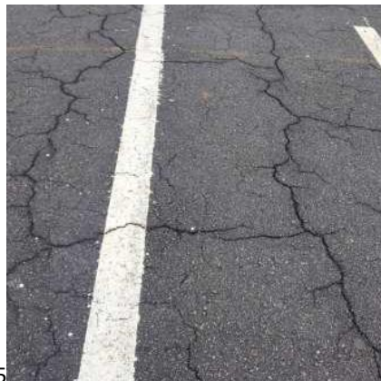
Figura 15: Trinca em bloco
