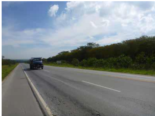
Figura 4: Afundamento de consolidação
