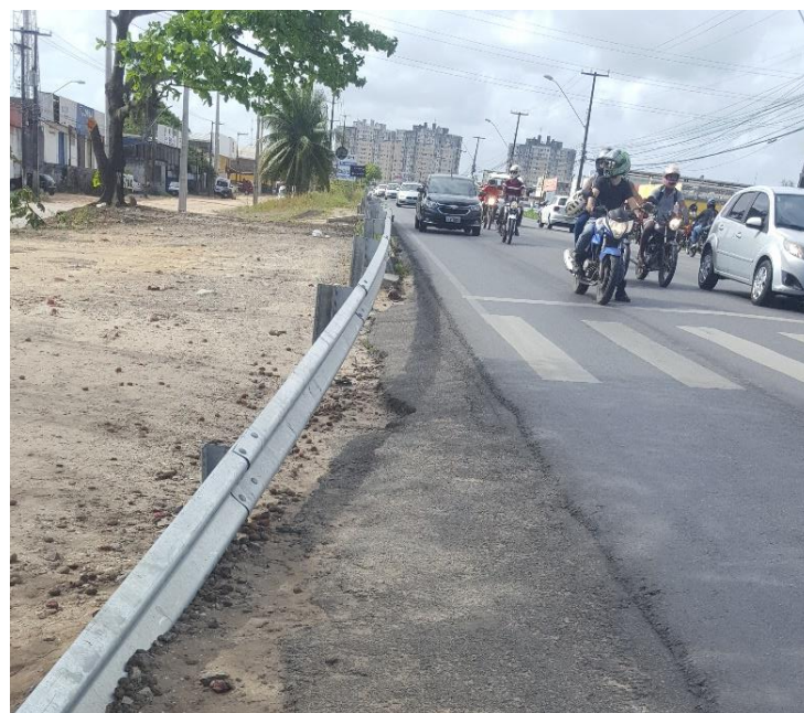
Figura 28 - Ausência de calçada após faixa de pedestre e priorização do automóvel.
