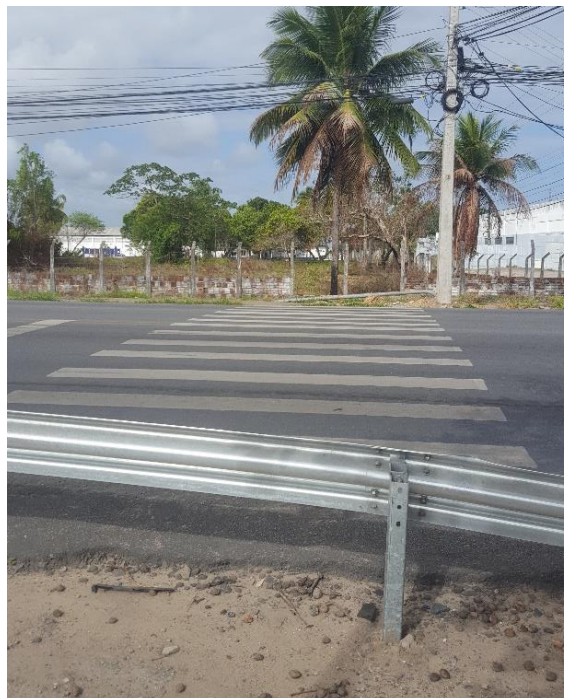
Figura 38 - Travessia sem calçada, com faixa bloqueada e sem semáforo para pedestres.
