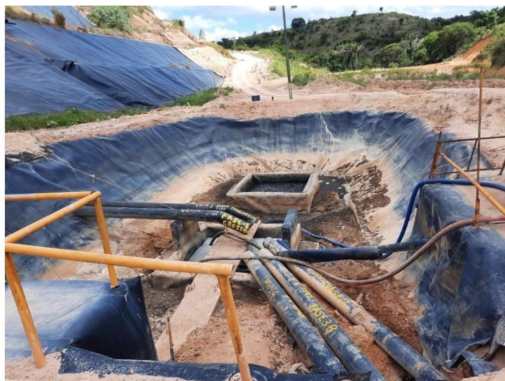
Figura 7: Poço de sucção da elevatória onde fica a bomba de recalque
