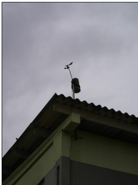
Figura 8: Estação pluviométrica no aterro sanitário de Maceió.
