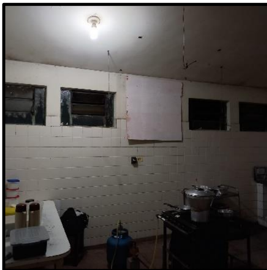
Figura 6 - Iluminação e ventilação inadequada
