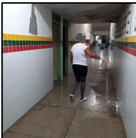
Figura 7 - Falta de sinalização de alerta em ambientes com piso molhado/escorregadio
