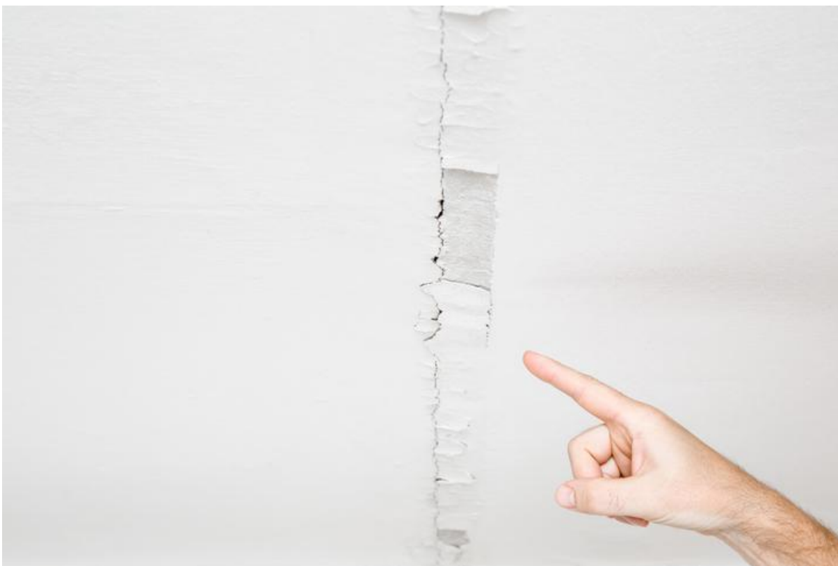
Figura 11: Fissura em placa de gesso acartonado por dilatação e contração térmica
