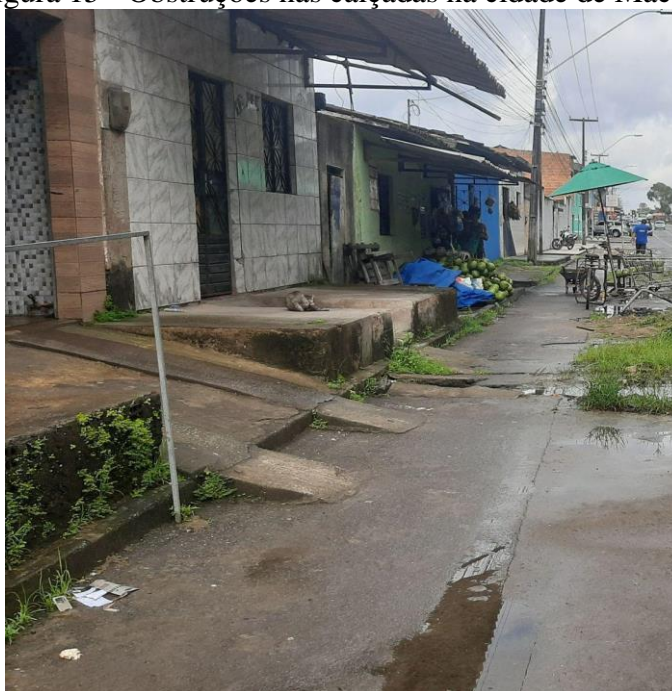
Figura 15 - Obstruções nas calçadas na cidade de Maceió
