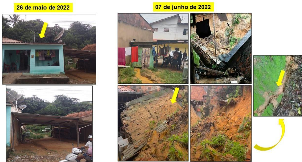
Figura 13: Área de risco 10 antes e depois do deslizamento e desmoronamento.
