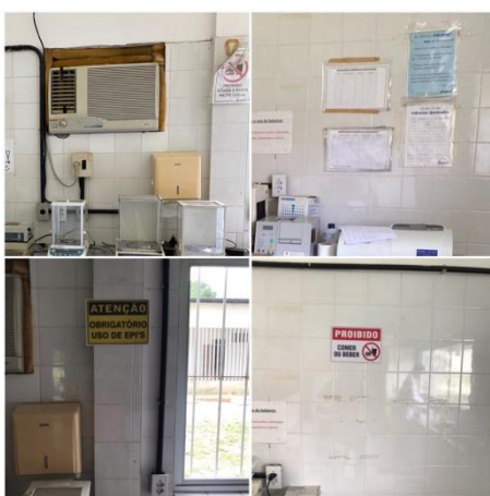
Figura 13. Instalação Sinalizações de Alerta e Proibição (Laboratório).
