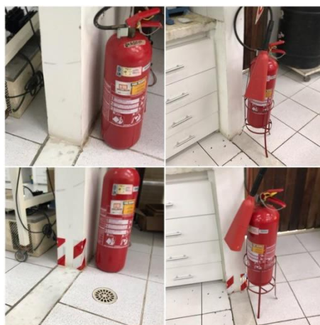
Figura 11. Instalação Sinalizações Complementares e Placa Equipamentos – Extintores (Salão 2).
