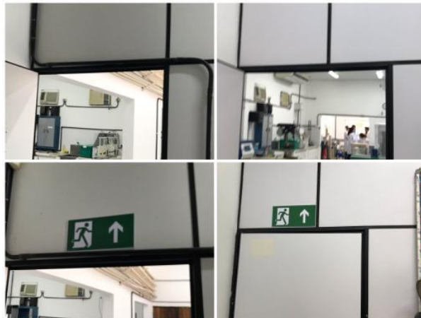
Figura 9. Instalação Sinalizações de Orientação e Salvamento (Salas de Estudo).
