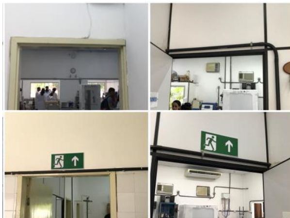
Figura 10. Instalação Sinalizações de Orientação e Salvamento (Salas dos Professores).
