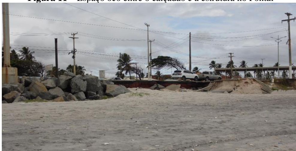
Figura 11 – Espaço oco entre o calçadão e a estrutura no Pontal
